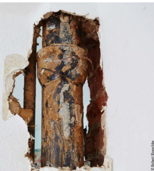
Demolierte Gasleitung und weitreichende Folgen.
