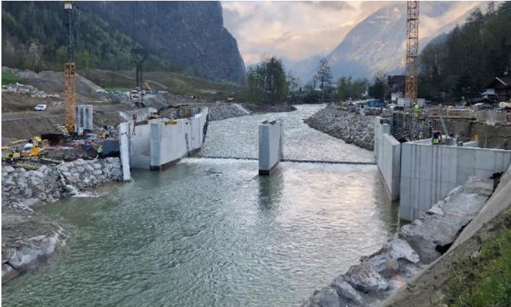
Wasserkraftwerk Tumpen-Habichen Ötztal
