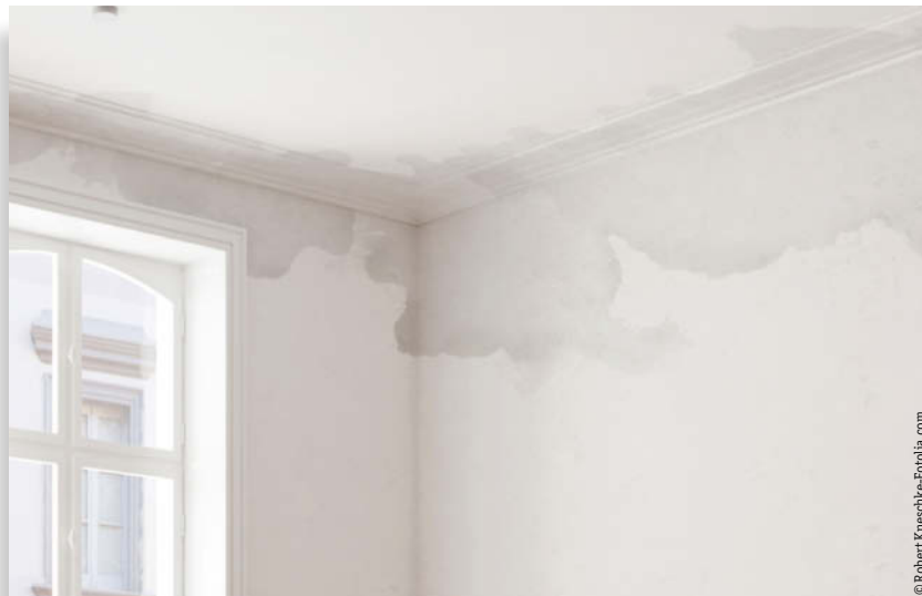
Durchfeuchtung des Mauerwerkes und die Folgen.
