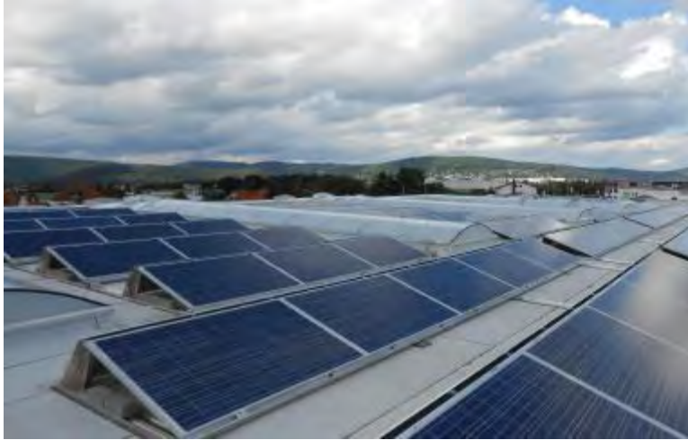
Luce Besitz GmbH; ca. 250 kWp
