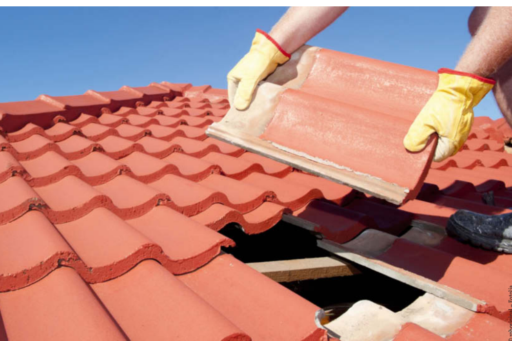
Wasserschäden bei der Dachsanierung.
