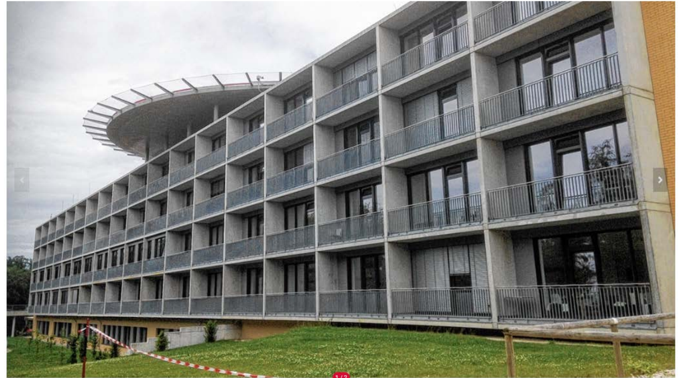
Schön, neu, leider verkeimt: Das Bettenhaus C im Klinikum auf dem Schlossberg hat ein Problem in seinen Wasserleitungen.
