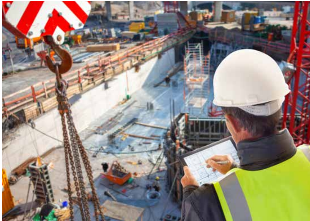
Damit digitale Bauverfahren künftig verstärkt in der Praxis zum Einsatz kommen, hat die Landesinnung Bau ein Pilotprojekt gestartet.
